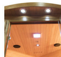
Luminaires intérieurs / extérieurs
